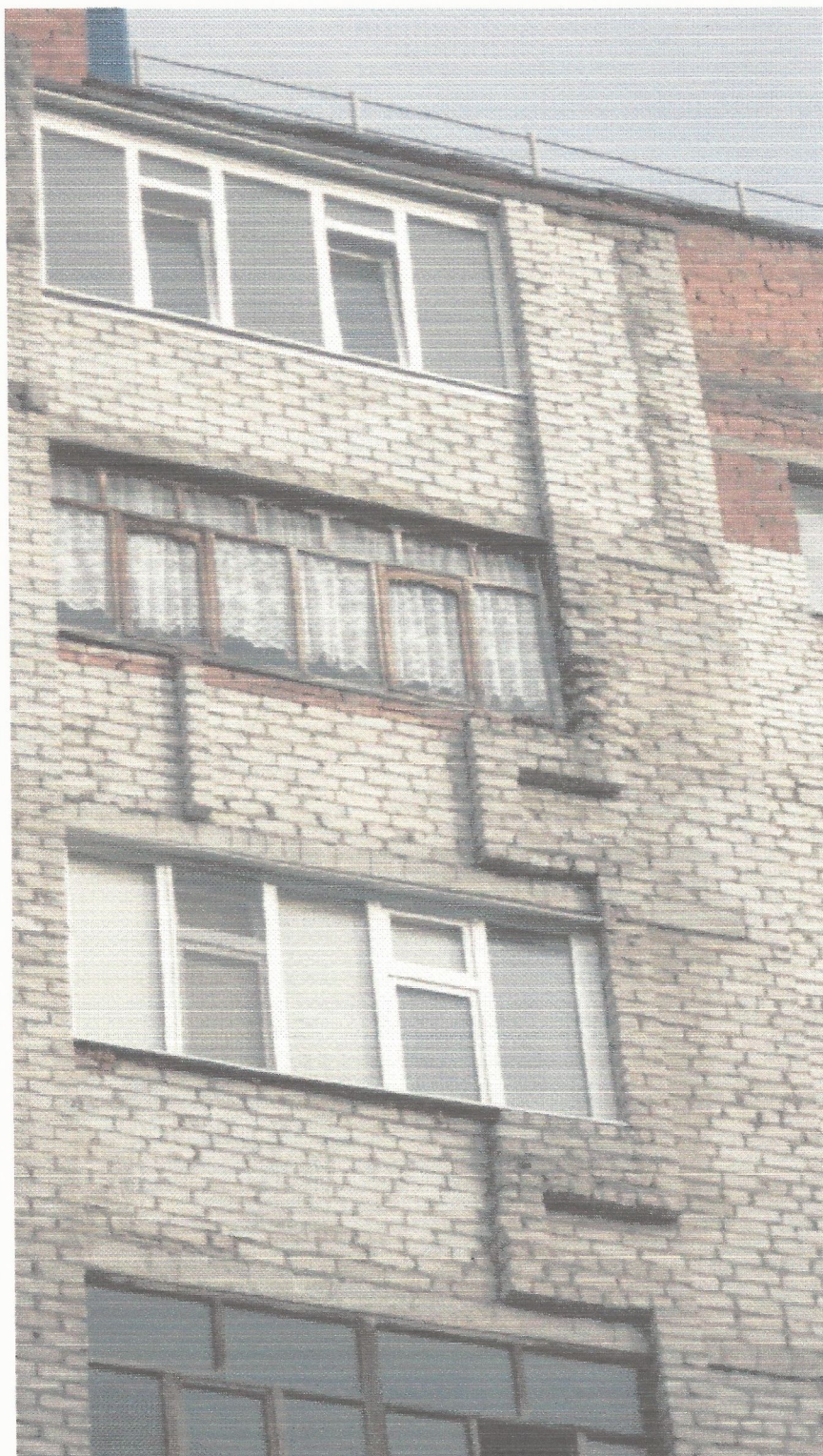
Разрушение кирпичной кладки
