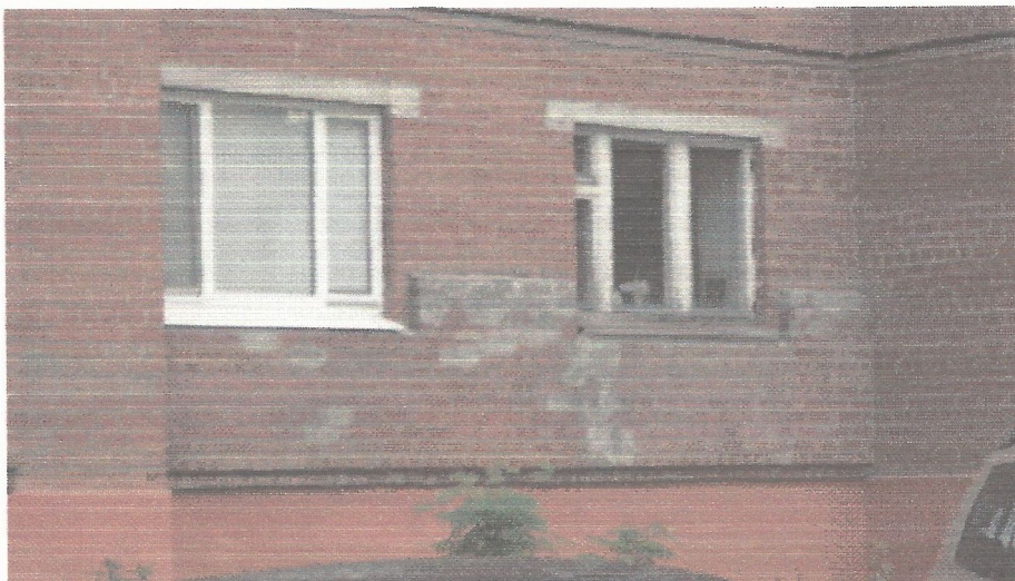
Разрушение кирпичной кладки
