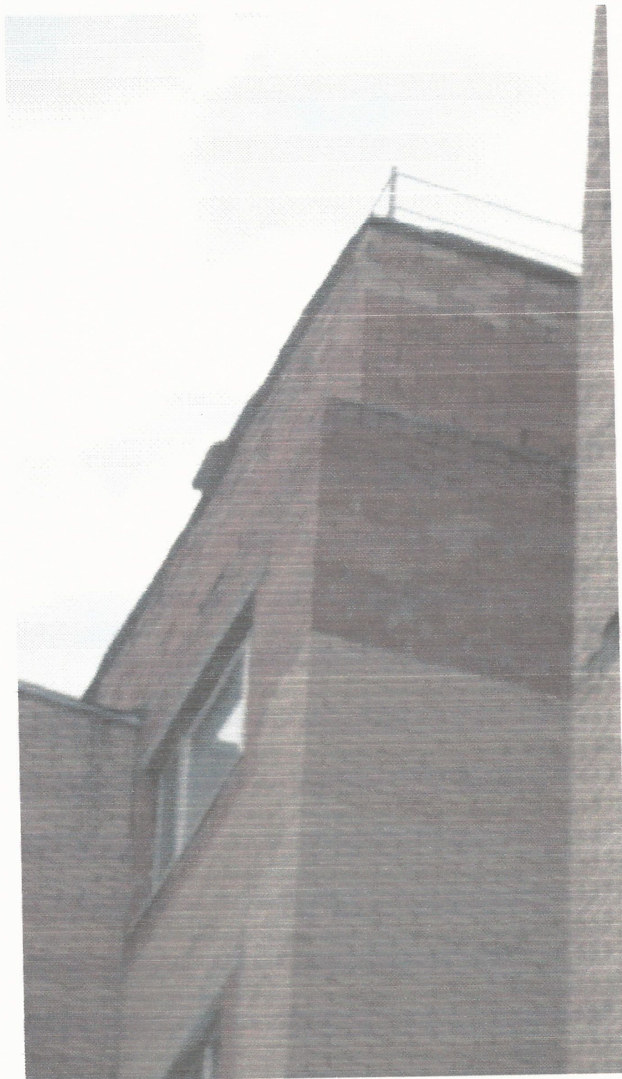
Разрушение кирпичной кладки
